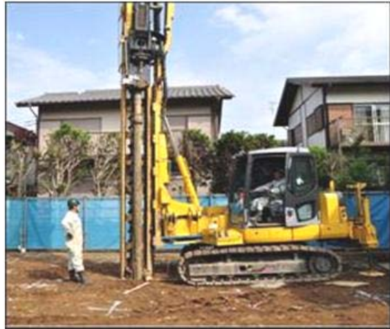
図4 軟弱地盤補強用の木杭の打ち込み状況（兼松日産農林・株）
