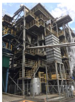
木質バイオマスボイラー
