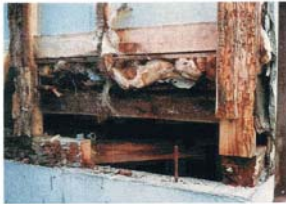
図 2.4.5 著しい腐朽被害 (南東面隅角部分) 柱、土台ともに腐れてしまった。 (撮影:同上)
